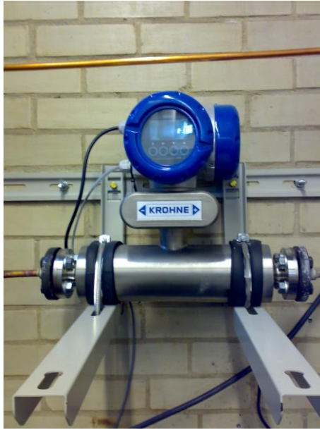
a) Flow meter
